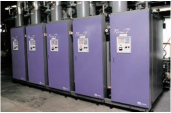
天然ガスボイラー
