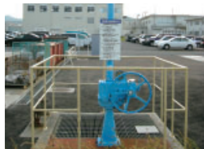
緊急遮断弁（郡山工場）
