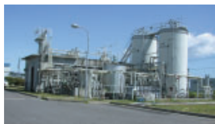
排水処理施設（郡山工場）
