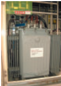
PCB含有が判明した相模事業所内の受電設備
