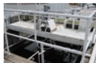
設備更新を行った排水処理施設（阿蘇工場）
