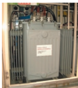
PCB含有が判明した 相模事業所内の受電設備
