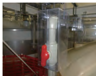
漏洩防止目的のカバー
