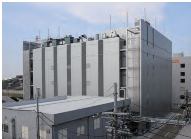
スーパークリーンルームを稼働させる相模事業所・新C-1棟(建設中)
