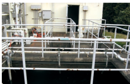
排水処理施設（御殿場工場）
